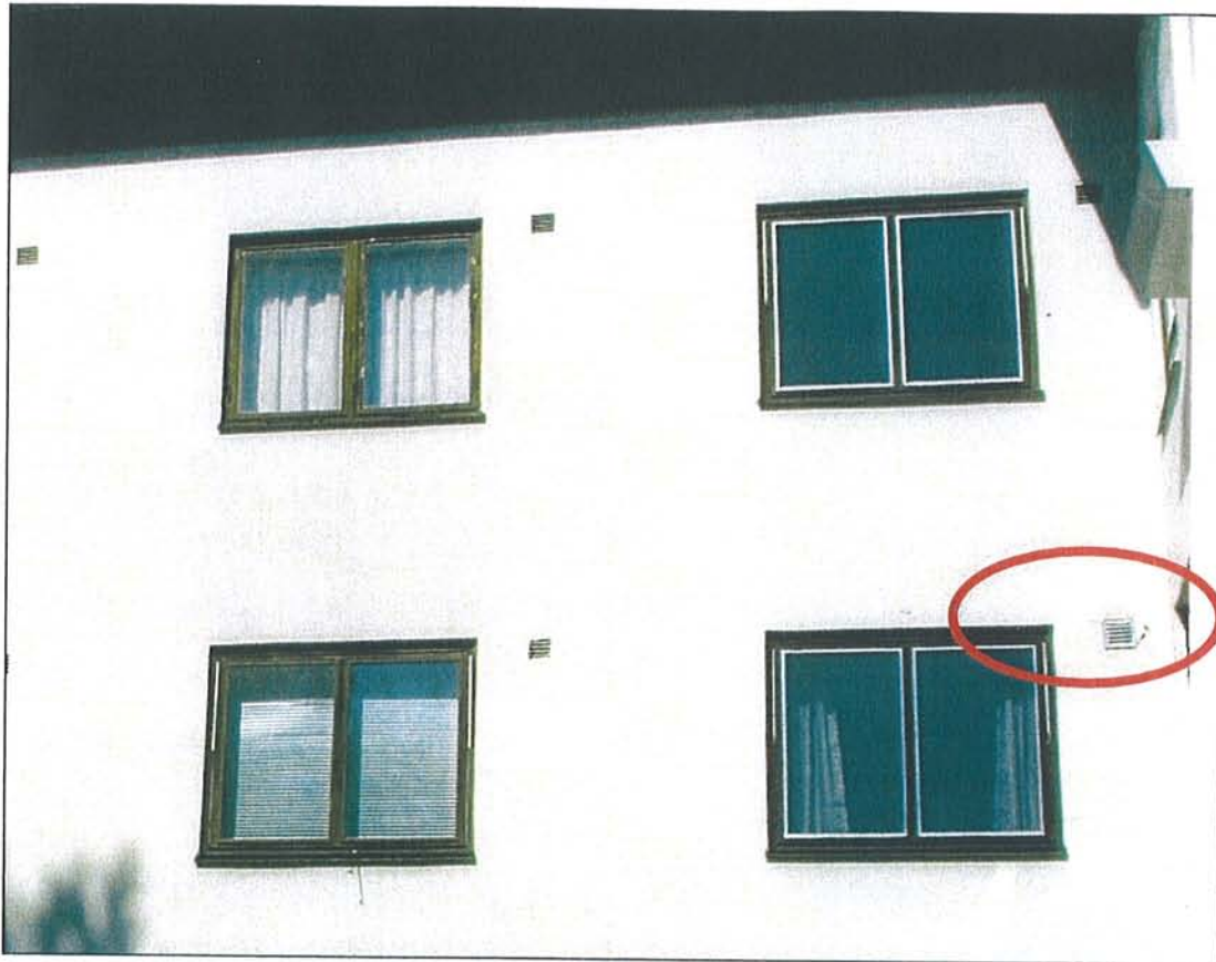
Foto 9: Østfasaden på Øygaardveien 68. Her er det en del horisontale riss ut fra vinduene. Det er også ettermontert en annen ventil i fasaden her.
