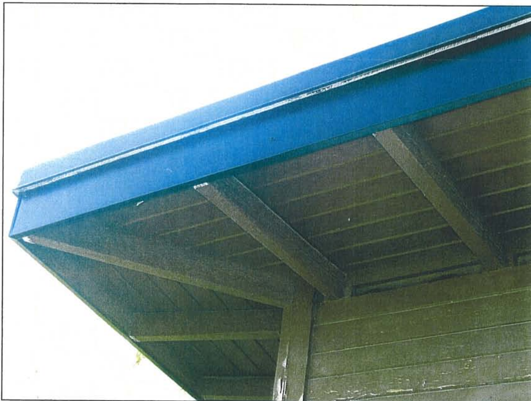
Foto 2: Noe avflaket maling på toppen av veggen.
