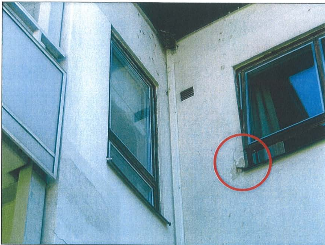
Foto 7: Pusskader ved sålbenkbeslag. Her fra vestfasaden på Øygdaveien 70.
