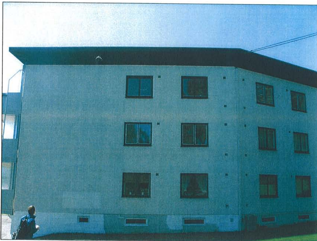
Foto 10: Her ser vi klart blokkmønster og etasjeskiller gjennom skitten på fasaden. Dette er fra Øygaardveien 66.
