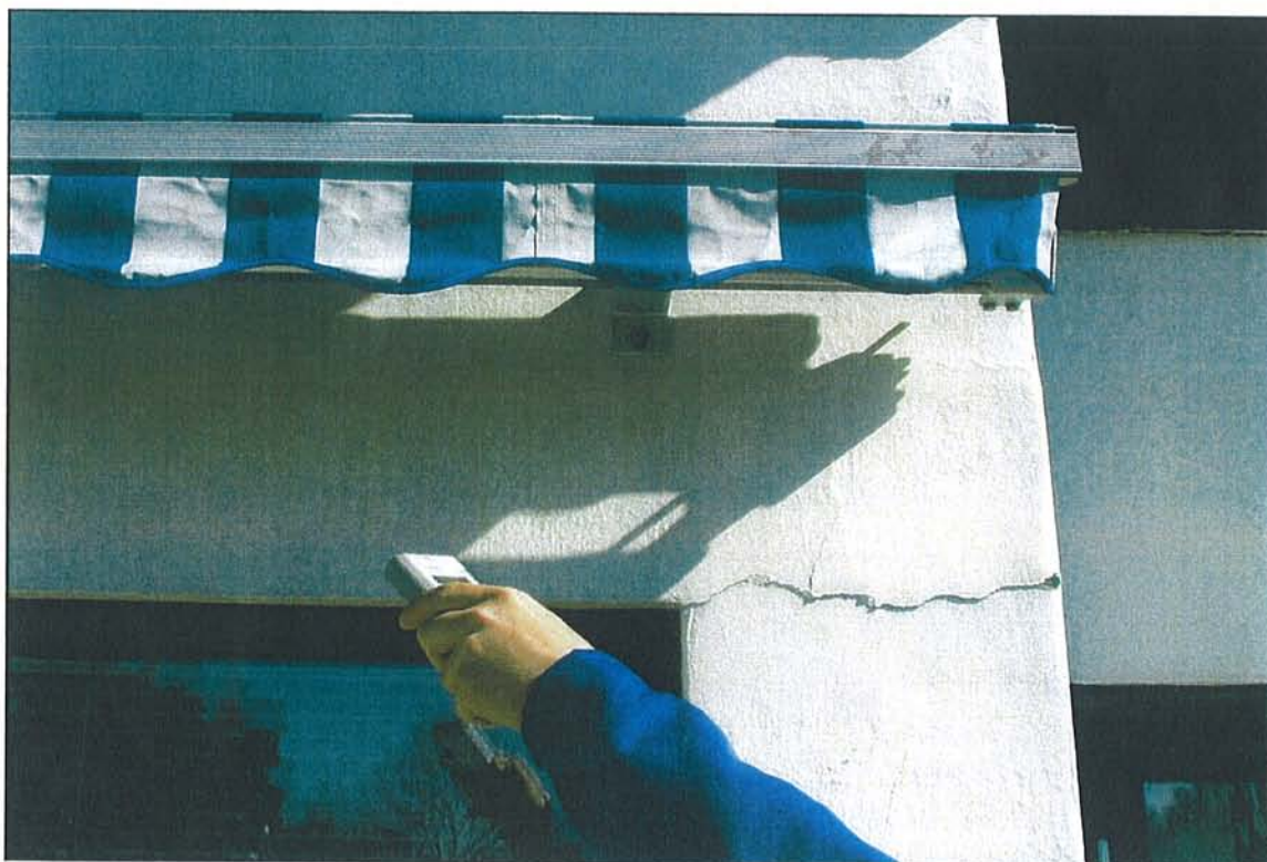
Foto 4: Avskallet puss fra fasaden. Trolig kan det være korrodert armering i bakkant i dette området som sprenger løs pussen.
