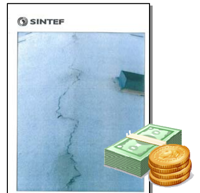
Foto 5: Sprekk midt på nordveggen på Øygardveien 72. Sprekken er gjennomgående i hele pusslaget, og inn i blokkene bak.
